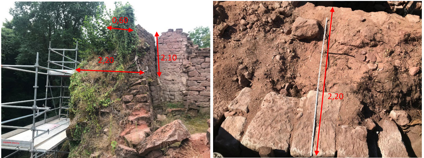
Photos annotées n°2 et 3
