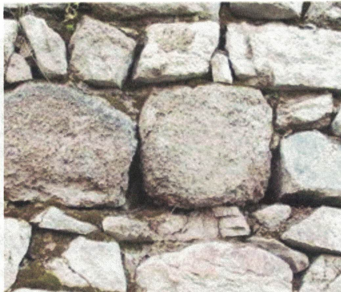
Exemple de mur en appareil mixte employant des calles de formats variés, avec joints dégradés entraînant à terme la perte de calles
