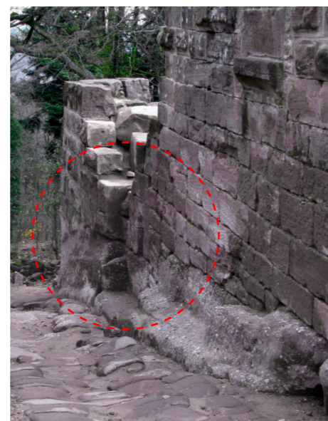
18 Pénétration d'humidité et remontées capillaires
